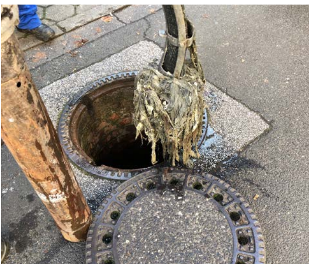
Abbildung 7: Verstopfter Kanal (Quelle: Hamburger Stadtentwässerung AÖR)
