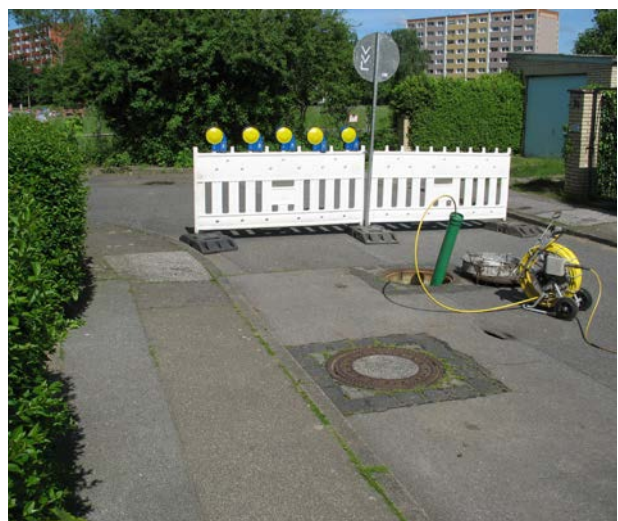
Abbildung 8: Einsatz eines Kompaktfettabscheiders (KFA) (Quelle: Hamburger Stadtentwässerung AÖR)
